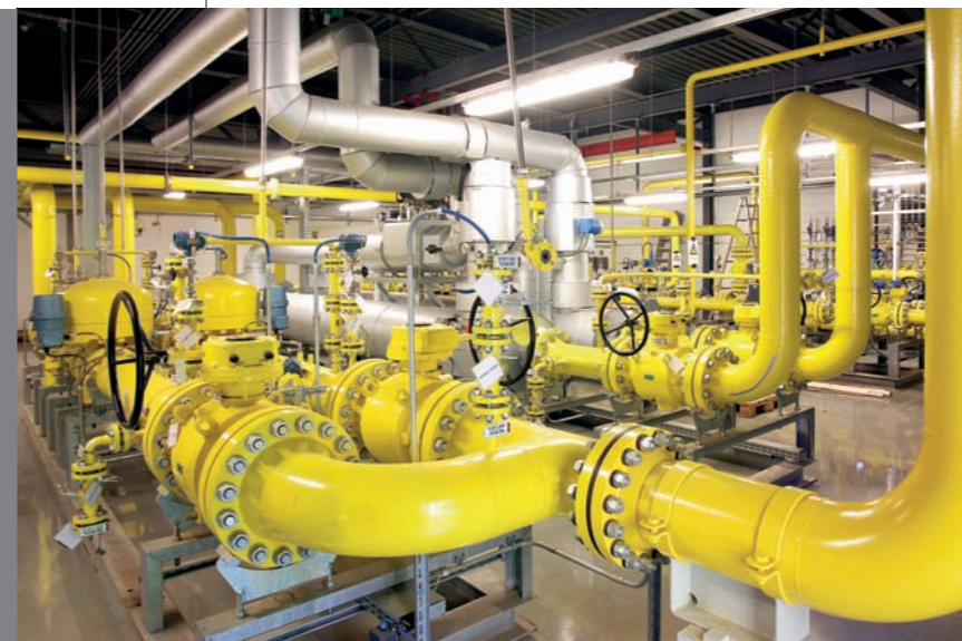
Mess- und Regelstation Gas
