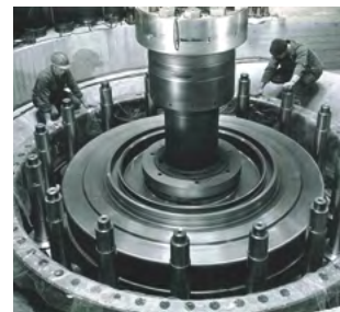
1968: Einbau der Pumpturbine
